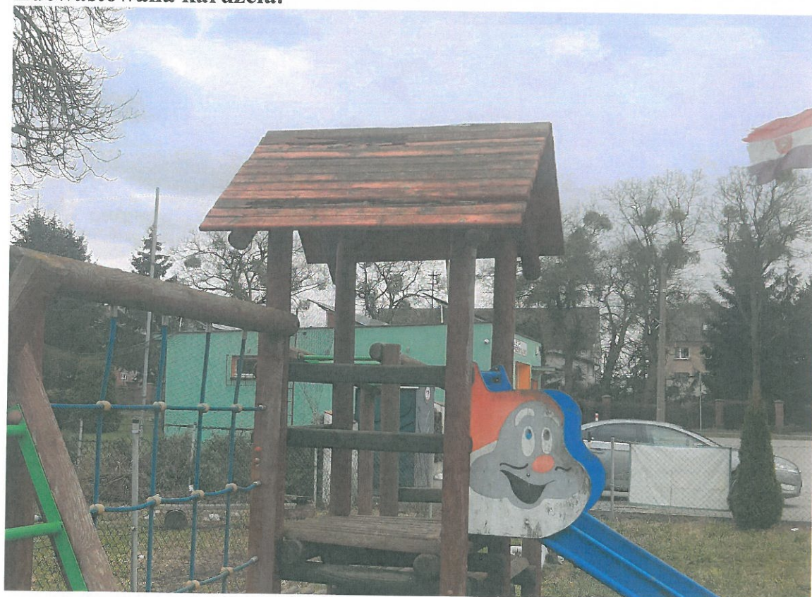
Zniszczony daszek nad zjeżdżalnią.
