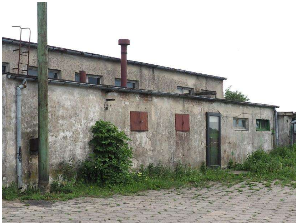
Zdjęcie 5. Przestrzeń zdegradowana – budynek po kotłowni osiedlowej
